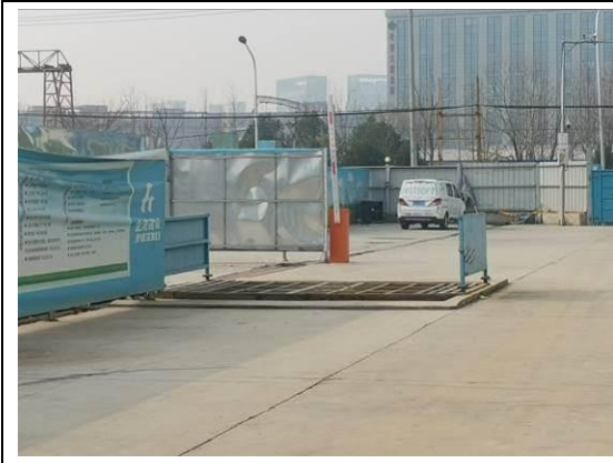
图 4-13 洗轮机沉淀池
