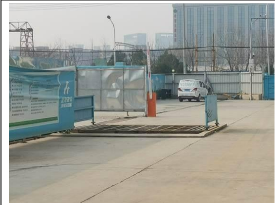
图 13 洗轮机沉淀池
