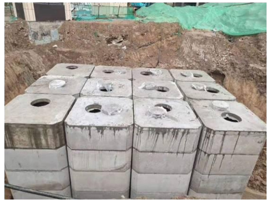
图 4-6 4#楼南侧雨水调蓄池
