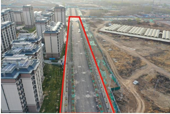
H 南侧便道与生产区已腾退并正在用于东源路建设（2023 年 6 月）
