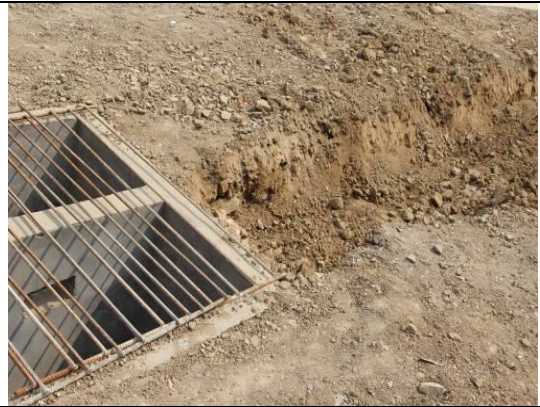
图16 临时排水沟、沉砂池
