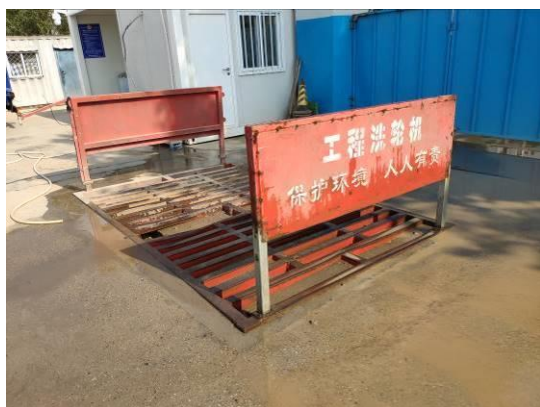
图3-21 施工出入口车辆清洗槽
