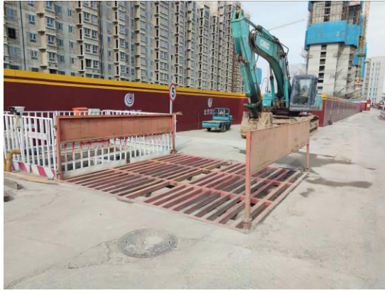
入口处车辆清洗槽 (2021年3月)
