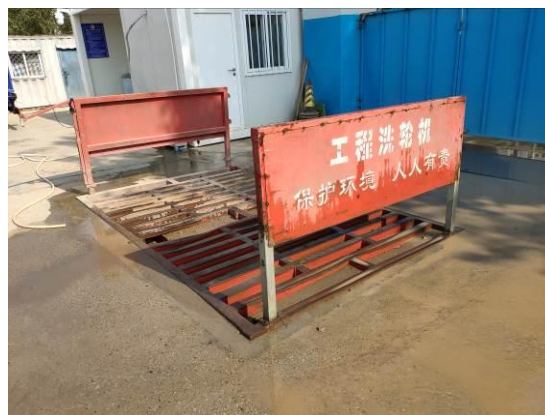
入口处车辆清洗槽 (2017年8月)
